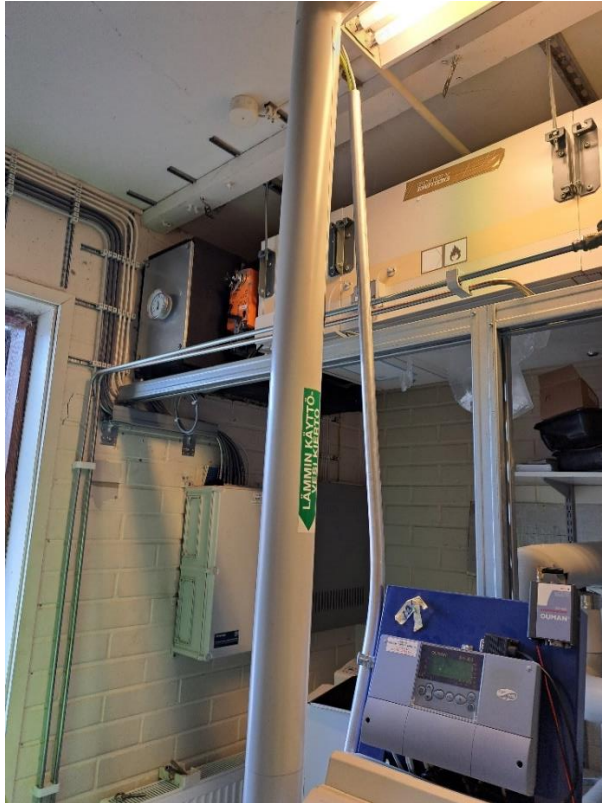
Kuva LV17 Ylhäällä keittiön 2018 uusittu tuloilmakone TK2
