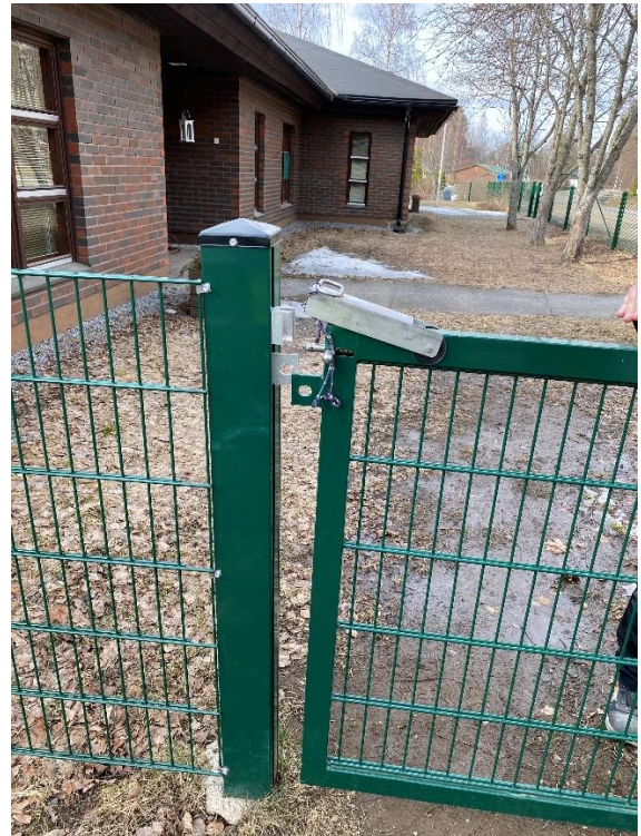
Kuva RAK 11 Portin käynti/lukitus korjattava
