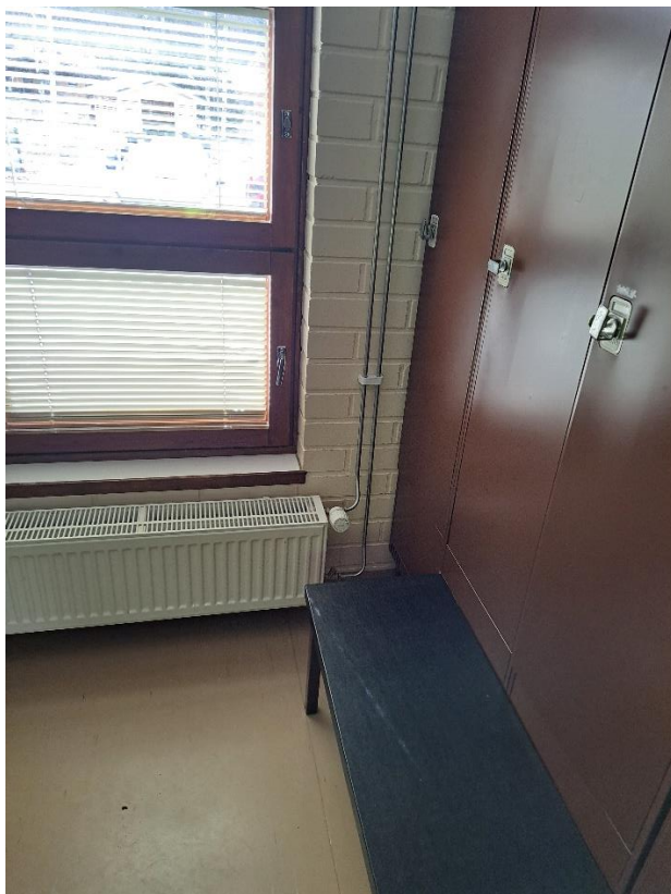
Kuva LVI4 Lämmityspatteri ja patterin kytkentäjohdot
