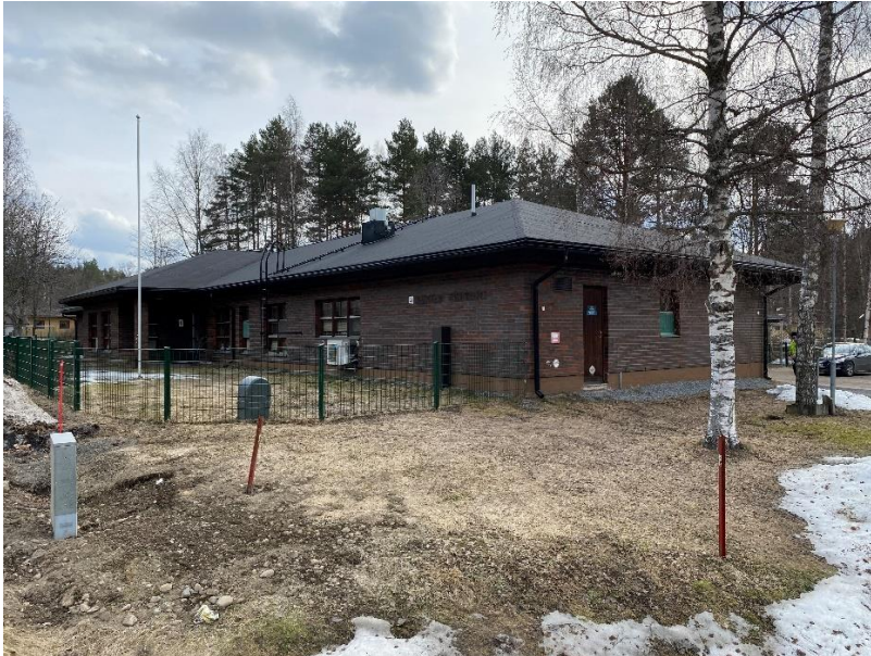
Kuva RAK1 Majavatien puolen maanpinnat kaatavat rakennukseen päin, kallistukset tulee korjata viettäväksi rakennuksesta poispäin.
