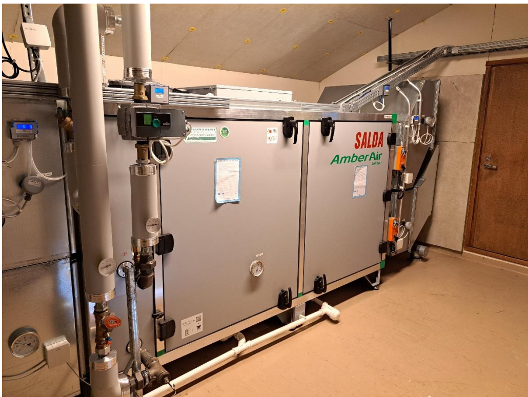
Kuva LV18 Päiväkotitilojen ilmanvaihtokone, asennettu 2018
