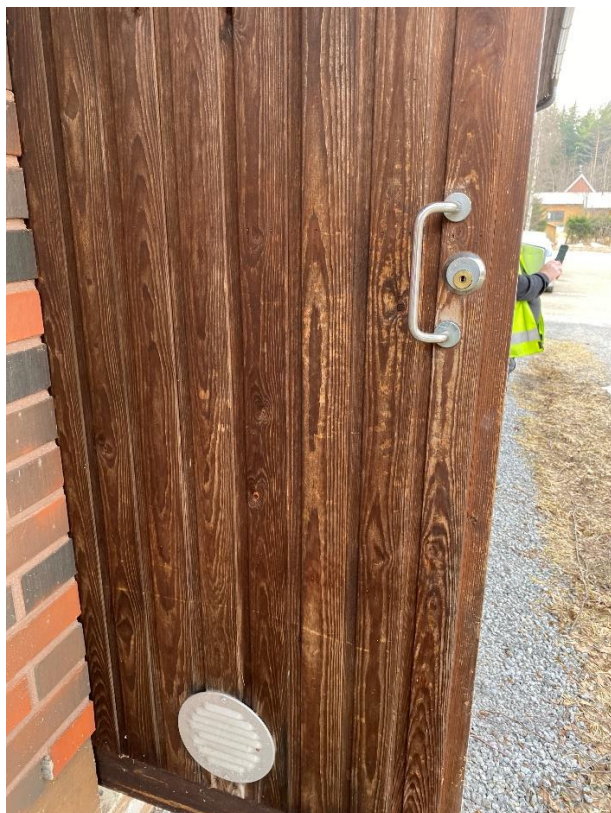
Kuva RAK4 Ulko-ovien puuosat kaipaavat uudelleenkäsittelyä
