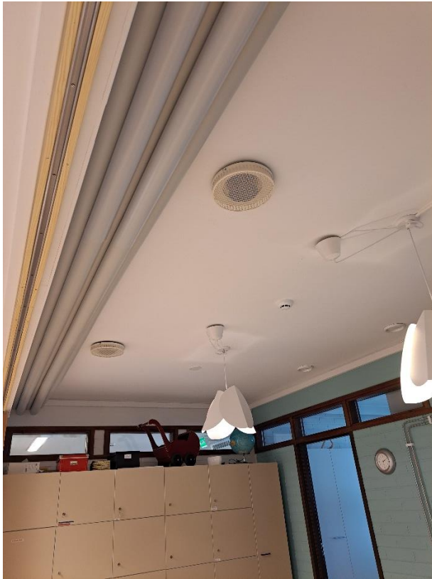
Kuva LVI5 Vesijohtoverkoston eristettyjä runkoputkistoja sekä ilmanvaihdon pääte- elimiiä.
