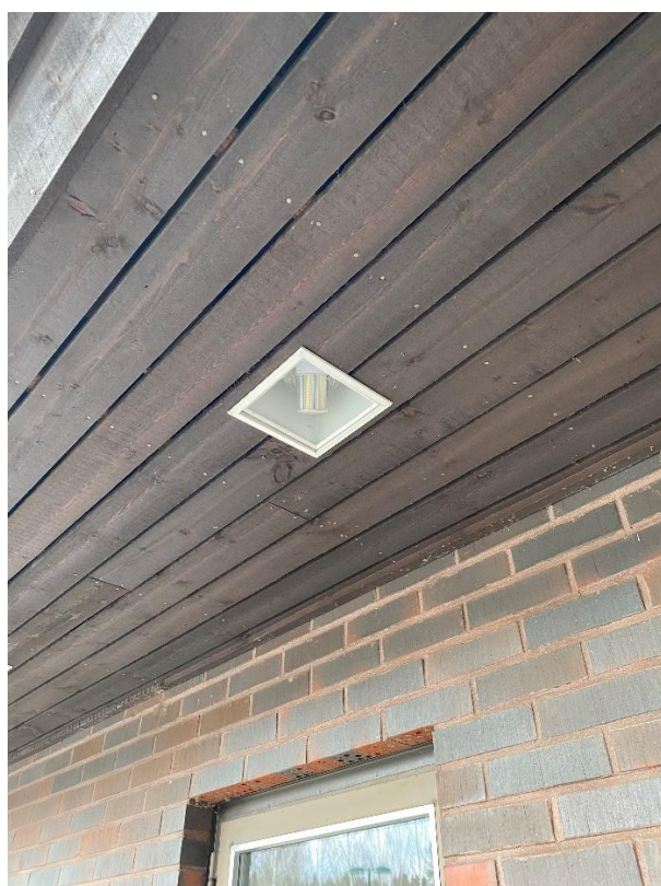
Kuva RAK6 Ulkovalaisimen ritilä puuttuu
