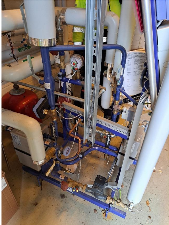
Kuva LVI1 Vuodelta 2011 oleva lämmönsiirrinpaketti, jota on täydennetty iv-lämmityslaitteella vuonna 2018
